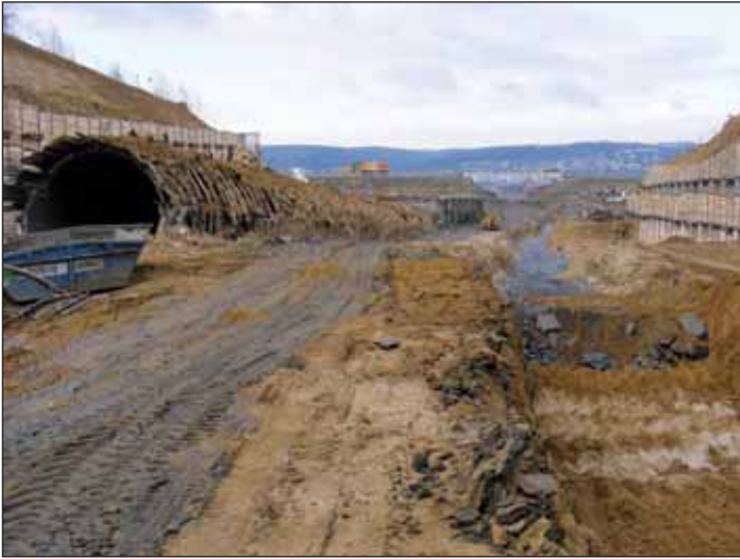
Obr. 8 Postupné bourání ostění přístupové štoly Fig. 8 Gradual demolition of the lining of the access adit
