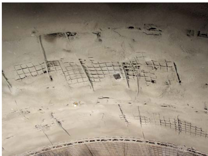
Obr. 13 Ukázka konstrukce po špatně provedeném nástřiku
