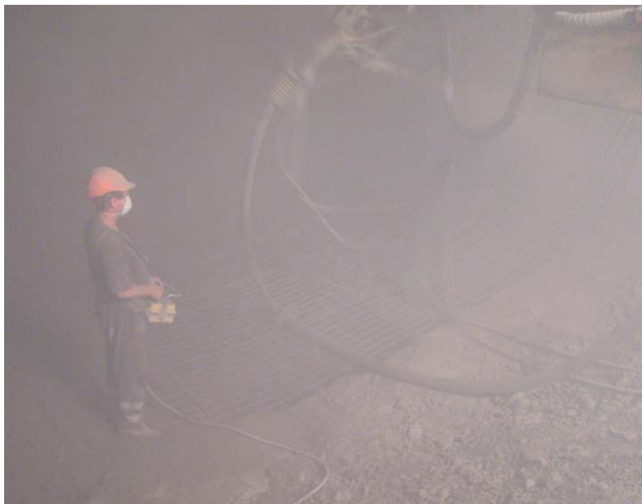
Obr. 12 Nadměrná prašnost při nevhodném nastavení suchého způsobu nástřiku betonu
